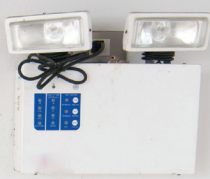
Éclairage de sécurité illuminant le corridor vers une issue de secours
